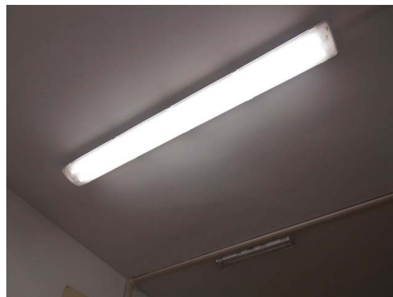
Figura 4.15 - Particolare dei corpi illuminanti ubicati nelle aule scolastiche
