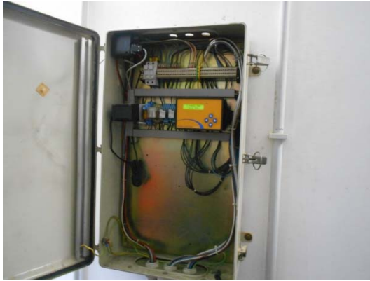
Figura 4.8 - Particolare della centralina di controllo dell'edificio
