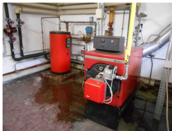
Figura 4.13 - Particolare delle caldaia per la produzione di acs e del volume di accumulo
