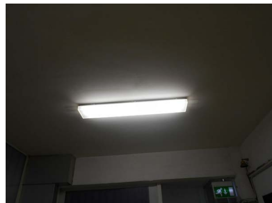
Figura 8.10 - Particolare di una plafoniera a tubi fluorescenti
